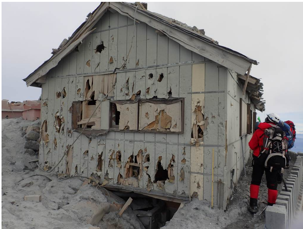
写真4 山頂（剣ヶ峰）の御嶽神社奥社建物の火口側（南西側）壁面. 山頂部の建物では火口側壁の損傷が著しい.
