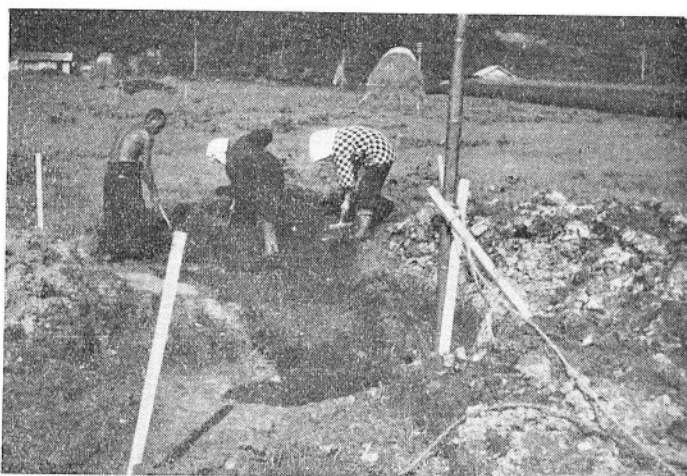
図版 27 胆振国長万部町北豊津附近で行った試験掘の例、試料採取後 竹管 (水位を常時測定するためのもの) を挿入して埋設しているところ。
