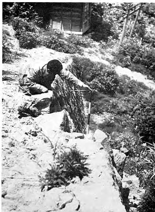
図版 55 鶴岡市湯野浜における石垣の水平ずれ (鶴岡市災害対策本部提供)
