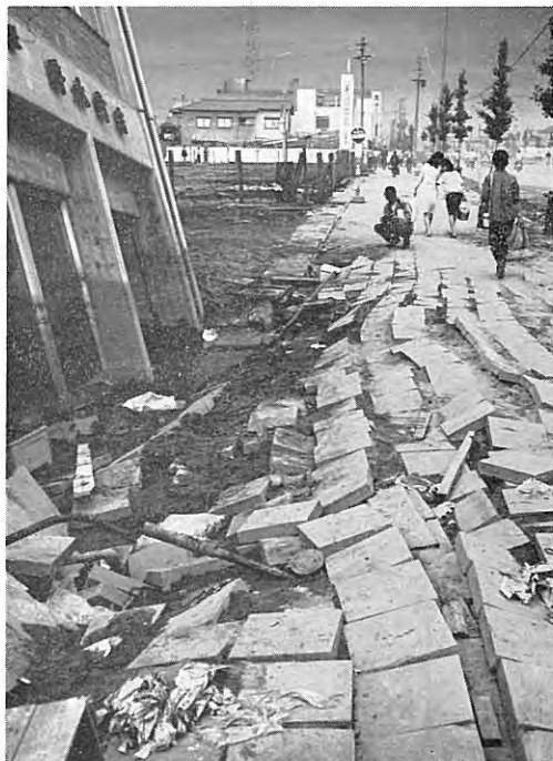
図版 29 図版 28 の沈下傾倒したビルディング前の歩道のみだれ 引きずりと同時に押し上げられている部分もみられる。
