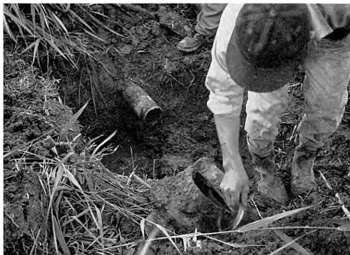
図版 73 村上市岩船における都市ガス輸送管の破損 (村上市災害対策本部提供)
