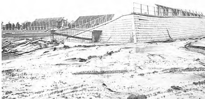
図版 3 泉磐グラウンド入口の路面の地割れと凹凸 スタンドが著しく挑曲沈下している。
