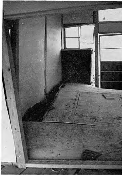
図版 42 図版 41 の内部 砂の盛り上がりで破壊された床板
