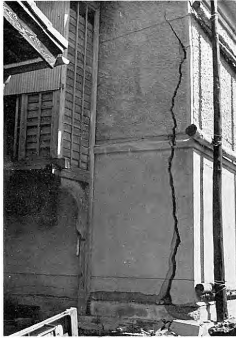
図版 60 羽越線勝木駅北方八幡山隧道北口付近の土蔵に生じた亀裂 (鈴木泰輔撮影)
