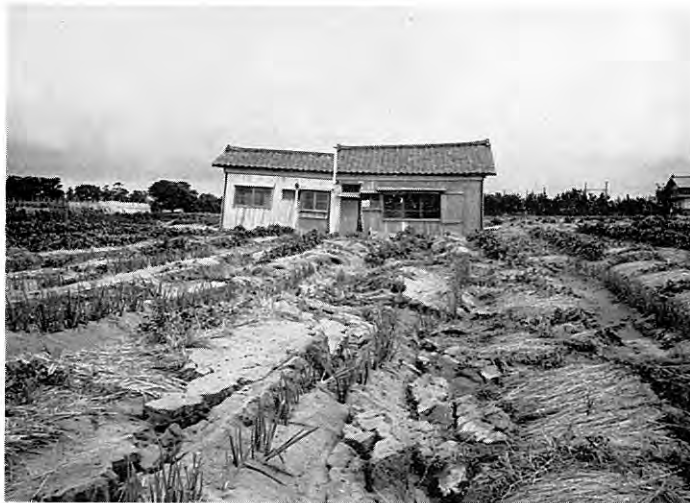
図版 41 地割れによって、ひきさかれた新築の木造家屋 噴砂を伴う地割れ群がほぼN-Sに走る。
