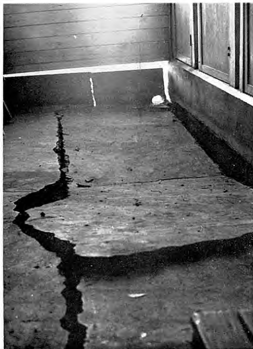
図版 54 鶴岡市西郷小学校校舎内の地割れ (鶴岡市災害対策本部提供)
