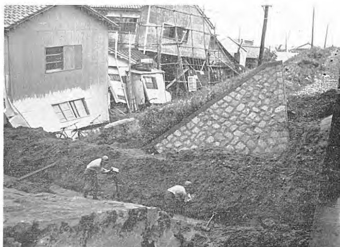
図版 12 図版 11 と同地点擁壁の傾倒と盛土ぞいの破壊された家屋
