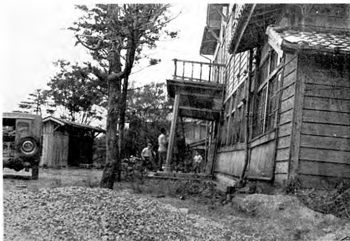
図版 88 新潟県北蒲原郡中条町(5) 役場乙支所(乙・大出両部落間)の破損。敷地内には多数の小規模な亀裂がみられる。 (鈴木泰輔撮影)
