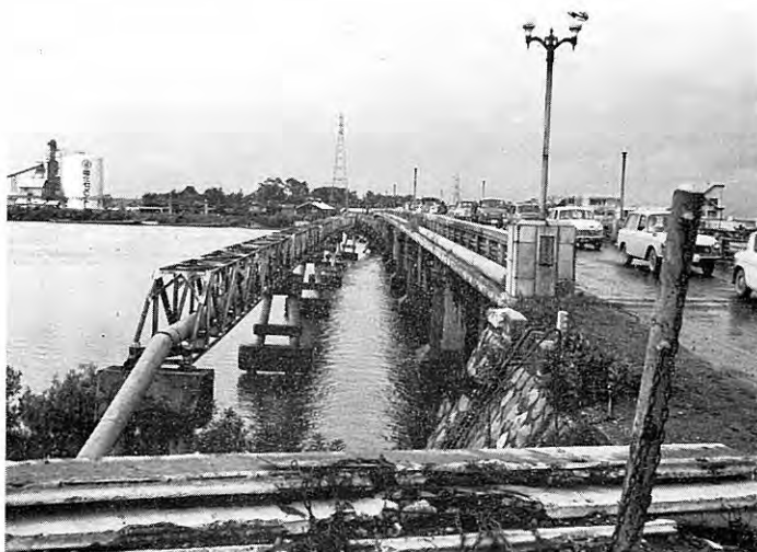
図版 25 帝石橋と並走している天然ガス輸送管の脚の倒壊
