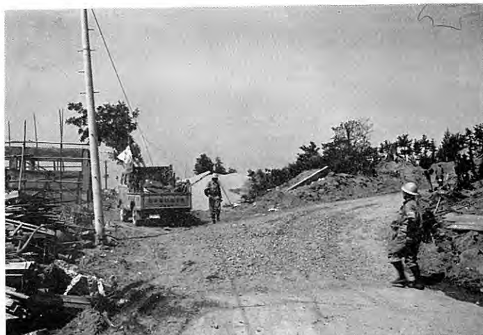
図版 34 図版 33 の溜まりの部分 中央にコンクリート道路（内野街道）の顕著な局部的隆起部がみられる。この隆起部の隆起量約 3 m。溜まりを切り開いて臨時の道路としている。（第 3 図参照）
