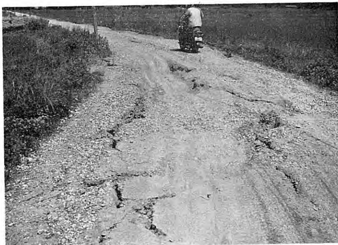
図版 67 村上市四日市・西興屋間における道路面の地割れ (村上市災害対策本部提供)
