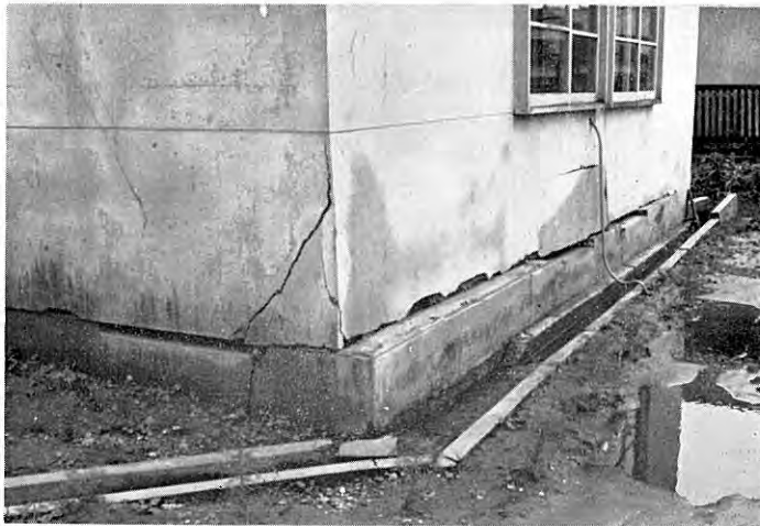
図版 85 新潟県北蒲原郡中条町 (2) 大出小学校校舎に生じた亀裂 建物は建築後3年ほどしかたっていないが、基礎から最大30cmも 移動している。(鈴木泰輔撮影)
