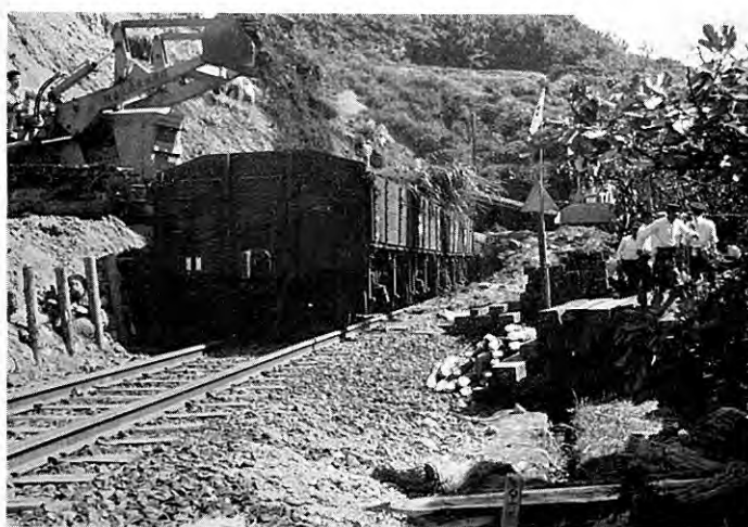
図版 57 羽越線勝木駅北方八幡山隧道北口の崖崩れ (1) 北側から八幡山隧道を望む。(鈴木泰輔撮影)
