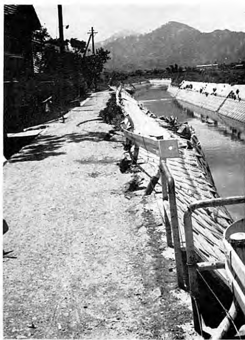
図版 56 鶴岡市内青竜寺川の岸壁破損 (鶴岡市災害対策本部提供)
