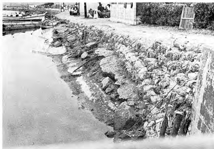
図版 77 村上市岩船明神橋上流左岸の破損 (鈴木泰輔撮影)
