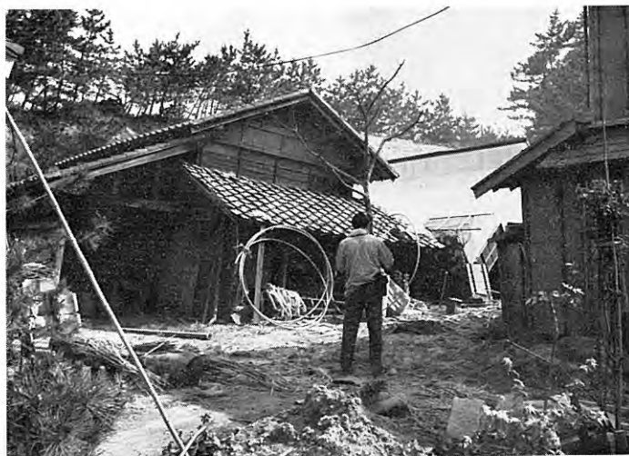
図版 31 内野街道砂丘の縁辺部で不同沈下により倒れた土蔵
