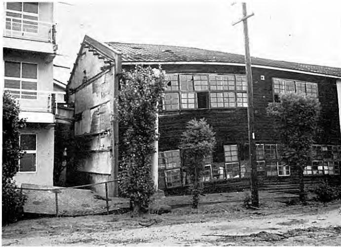
図版 9 不同沈下で撓曲した木造家屋 左下の下水槽が浮き上がっている。 (信濃川北西岸地域) (図版 14 参照)
