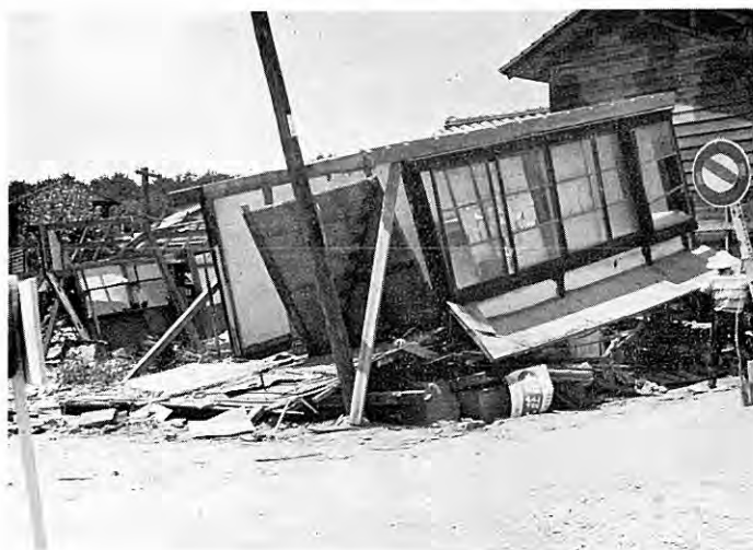
図版 75 村上市八日市における家屋の倒壊 (2) (村上市災害対策本部提供)
