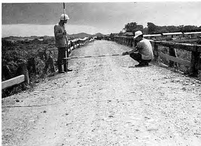
図版 68 村上市滝ノ前・瀬波間の橋梁（羽下ヶ滝橋）の破損（6月23日倒壊） （村上市災害対策本部提供）
