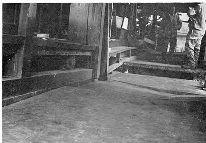
図版 83 新潟県岩船郡神林村塩谷部落 (4) 民家の内部。外見無被害のようにみえる家屋も、一步内部に入れば破 損がはなはだしい。床下に地割れが大小4条生じている。
