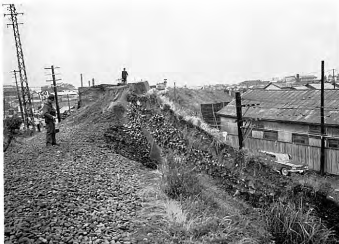
図版 10 越後線盛土路盤の地割れと崩壊路盤 2 m 以上下がっている。 (関屋・白山両駅のはほぼ中間、国道 18 号線陸橋の東側近く)
