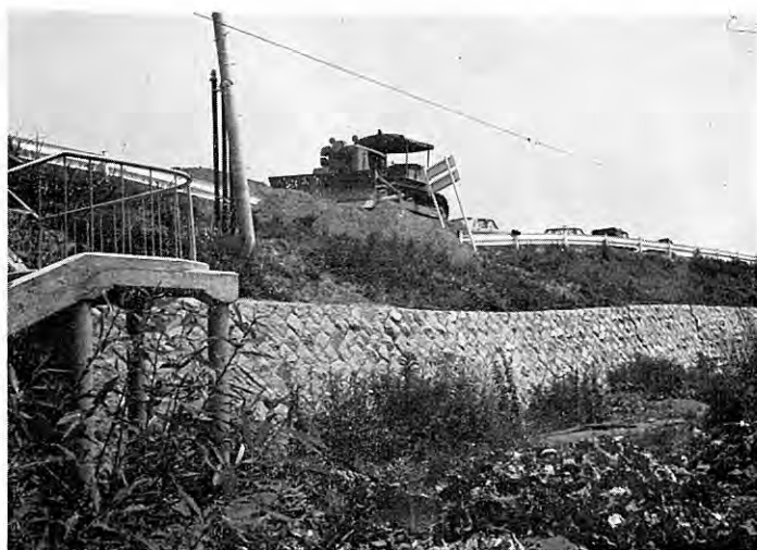
図版 51 大野大橋南側盛土のうねりと擁壁の亀裂 （白根市中ノロ川南岸）
