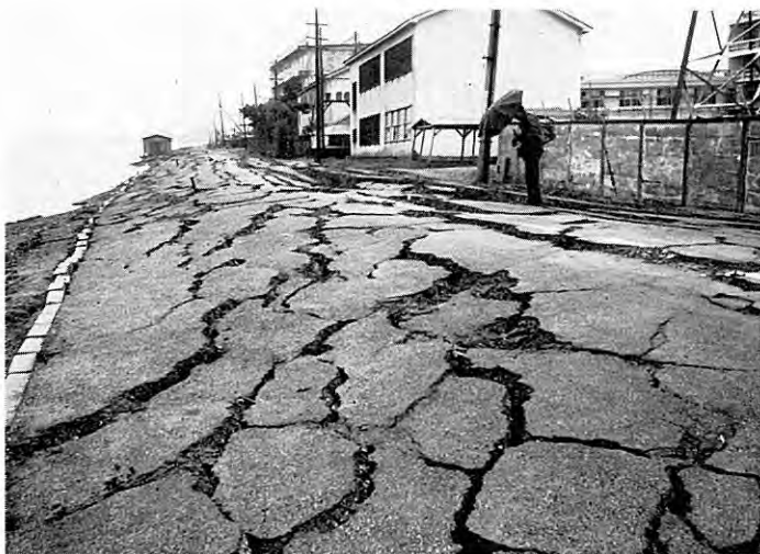
図版 15 信濃川北岸の地割れ 河道に向かって傾斜沈下すると同時に押し出している。噴出した砂はみられない。 (越後線信濃川鉄橋西方, 図版 14 参照)
