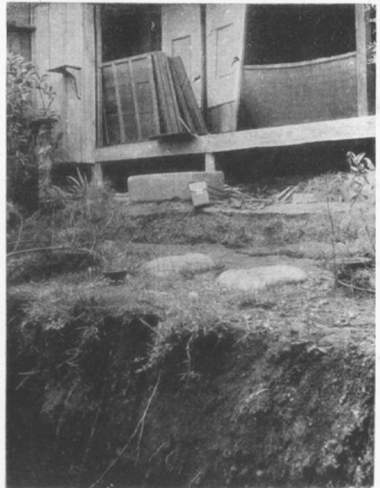
大井町一三九番地内邸ノ龜裂
