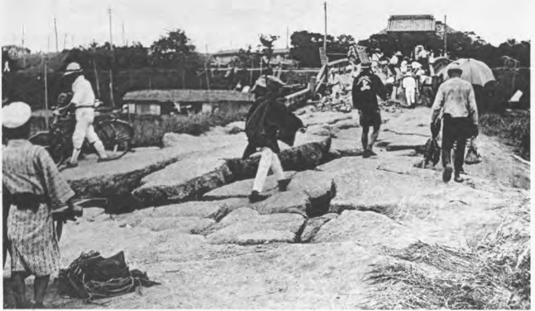
綾瀨橋橋臺面ノ龜裂
