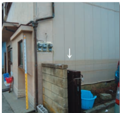
(図1) 茨城県ひたちなか市那珂湊における浸水の痕跡の例。図中の白矢印が示す水平方向の線が津波が浸水することにより生じた浸水線です。標尺により地面から約1.3m上まで浸水したことがわかります。現地調査ではこのような痕跡を根拠に津波の高さを測定しました。
