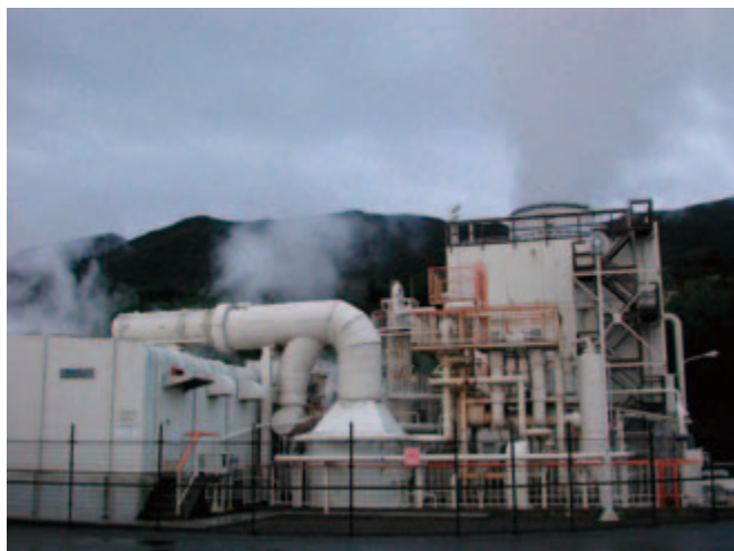
図1 八丈島地熱発電所。
