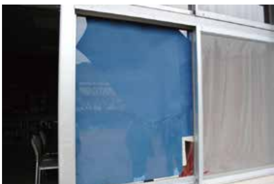
図4 空振による窓ガラスの破損(鹿児島県霧島市). 窓ガラスや外壁が破損しました。その他、降礫で太陽電池パネルなどの破損もありました。
