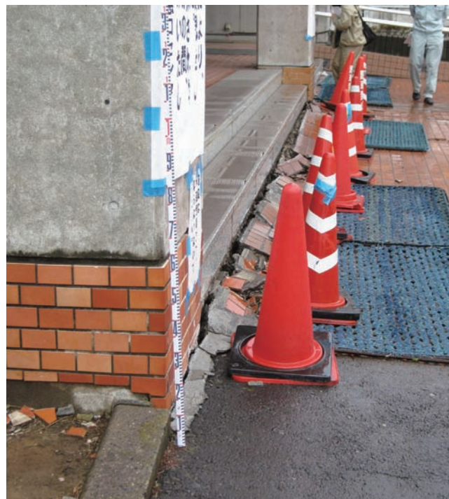
写真3 地盤沈下によって生じた「市民ホールやたべ」入口の段差。
