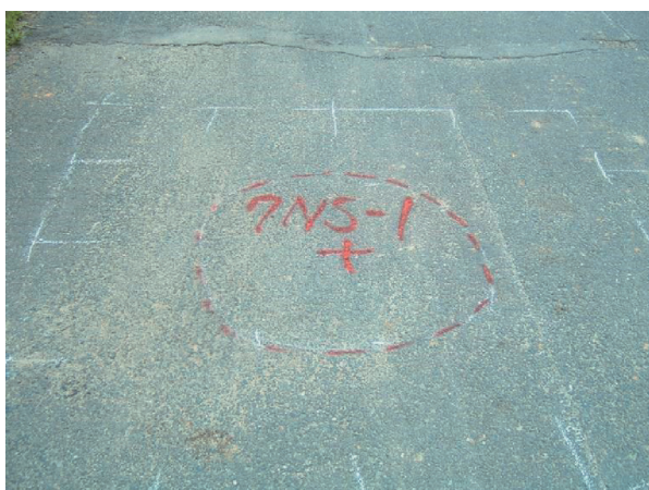
第 8 図 路面下のゆるみ領域が顕著と判定された箇所 で施された路面へのマーキング
