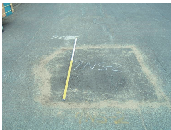
第 9 図 詳細追加調査の当日に道路補修が行われた地 点. この地点は車載型 GPR により異常信号が 抽出されていた.
