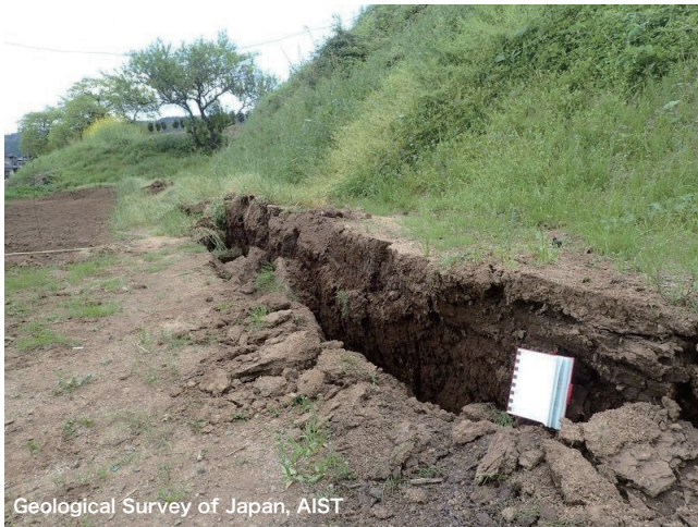
写真7 Fu4: 益城町三竹付近 横ずれと縦ずれを伴う
