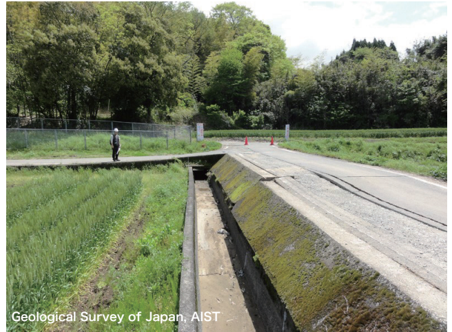
写真4 Fu1：嘉島町井寺付近（地表変位の西端） 約10cmの右ずれ
