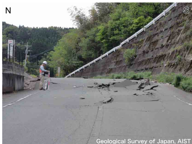
写真3 上陳集落の舗装道路に見られる短縮変形。写真は南東方向に向かって撮影。上下変位量は約40 cm。断層はN70E方向に続く。(2016年4月16日撮影)
