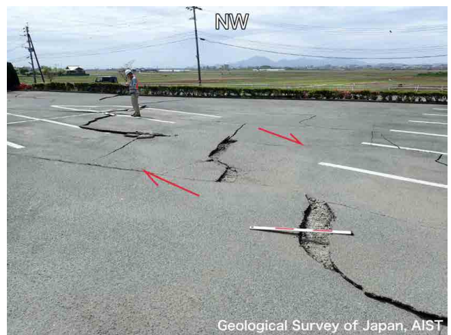
写真8 赤井集落「益城町町民いこいの家」駐車場に見られる右横ずれ変位。写真は北西方向に向かって撮影。右横ずれ変位量は約40～50 cm。(2016年4月16日撮影)
