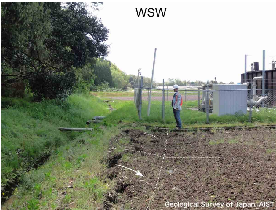
写真 16 櫛島集落南方の地形的高まりと水田との境界に生じた南上がりの開口亀裂と南側の掘み上がりによって生じた柵の変形。写真は西南西方向に向かって撮影。上下変位量はおよそ 20 cm かそれ以上。地形境界にそって南上がりの掘みと開口亀裂が連続的に見られる。白矢印は掘みの形状を表す。(2016 年 4 月 17 日撮影)
