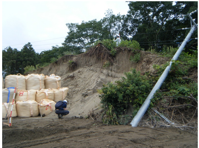
写真2 常総市若宮戸地区における河畔砂丘の高まり。越水の影響で電柱が東側に傾いている。
