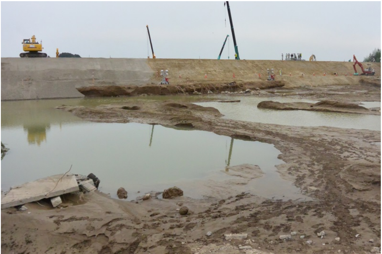
写真 6 常総市三坂地区の破堤箇所直近に形成された侵食地形（落堀）。破堤箇所には水害後の工事で仮堤防が造成されている（写真奥）。
