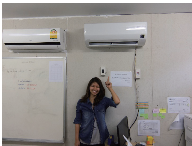
写真5 事務室に設置した室内機。
