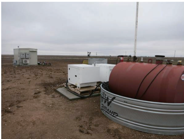
写真 13 2 台の発電機の自動切替で使用する自家発電システム。このタンクで 1 か月連続運転可能。ファーンズワースでは予備電源として使用されている。
