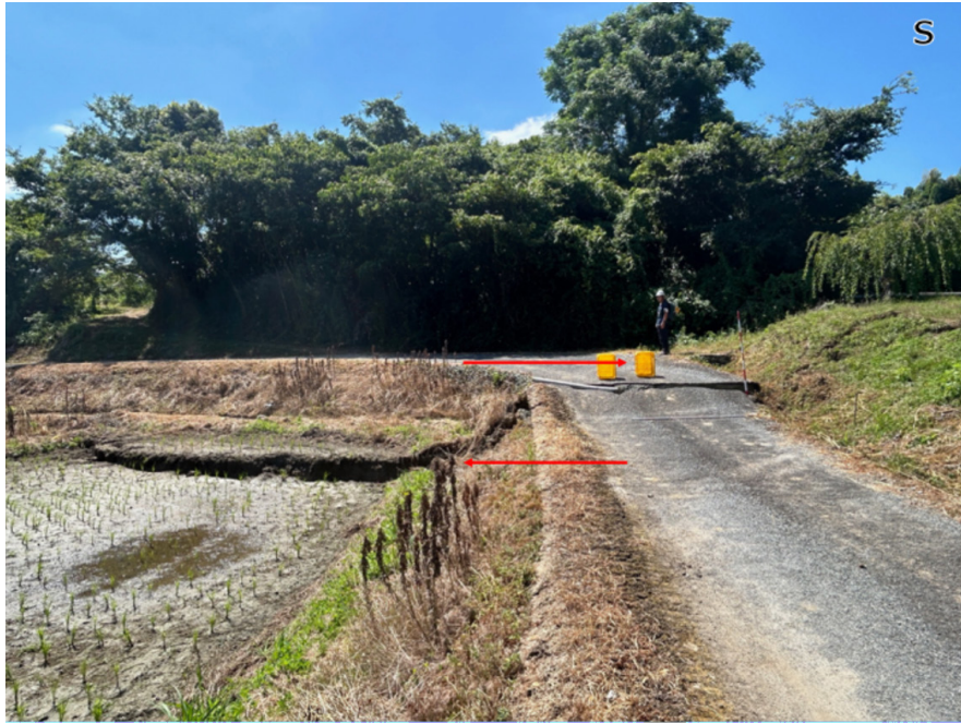
写真4 熊本県宇城市豊野町下郷の水田～舗装道路に見られる右横ずれ変位。舗装道路西端を基準にした時の右横ずれ変位量は43 cm，上下ずれ変位量は39 cm 北西低下。写真は南方向に向かって撮影（2026年8月1日撮影）。
