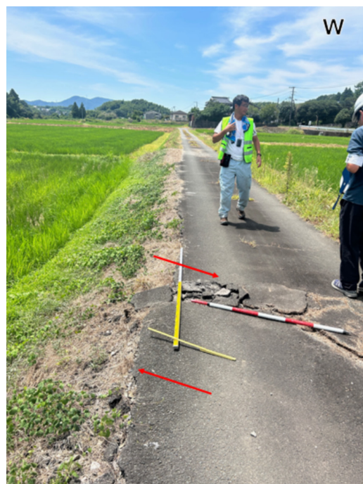
写真 2（左） 熊本県上益城郡御船町の舗装道路の補修跡。道路の白線が右横ずれをしている。白線を基準にした時の右横ずれ変位量は 15 cm。写真は北西方向に向かって撮影（2026 年 7 月 30 日撮影）。
