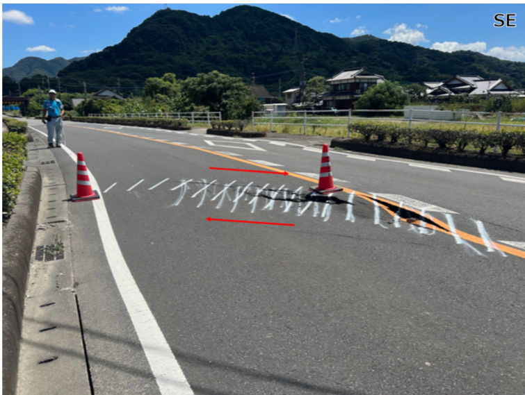
写真14 熊本市豊原上町の舗装道路に見られる右横ずれ変位。道路の白線を基準にした時の右横ずれ変位量は17 cm。上下ずれ変位は北東低下。写真は南東方向に向かって撮影（2026年7月31日撮影）。
