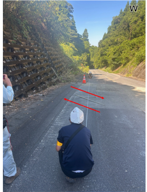
写真5 熊本県宇城市豊野町の娑婆神峠の舗装道路に見られる右横ずれ変位。道路の白線を基準にした時の右横ずれ変位量は98 cm。写真は西方向に向かって撮影（2026年8月1日撮影）。
