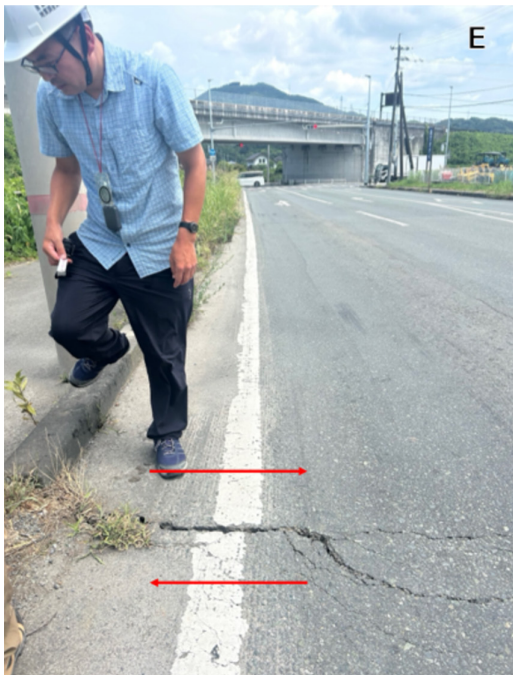
写真 1 熊本県上益城郡御船町の舗装道路に見られる右横ずれ変位。道路の白線を基準にした時の右横ずれ変位量は 6 cm。写真は東方向に向かって撮影。赤矢印は変位センスを表す（2026 年 7 月 30 日撮影）。
