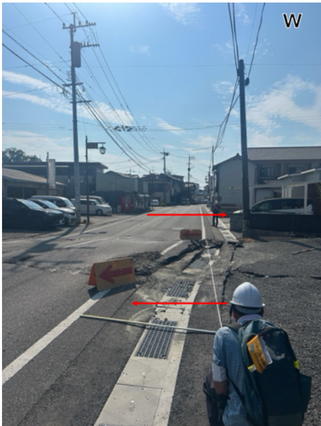
写真8 熊本県八代郡氷川町宮原の舗装道路に見られる右横ずれ変位。道路の白線を基準にした時の右横ずれ変位量は184 cm, 上下ずれ変位は西低下。写真は西方向に向かって撮影 (2026年8月2日撮影)。
