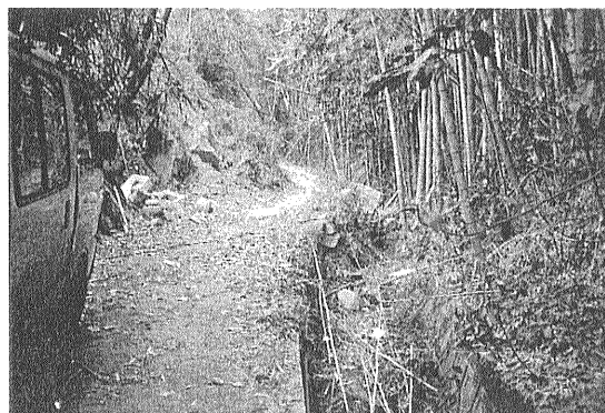
写真34-2 同場所の一部修復後の状況. 小道沿いの北岸(向かって左側)の側壁上部は1mほどはらみ出した[服部撮影(1996.1.29)].
