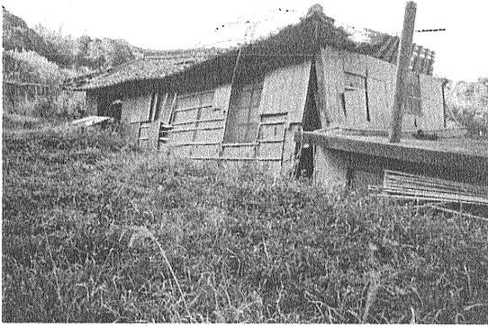
写真46-3 舗田氏邸北東隅の柵田端から見た東別棟の半壊傾斜状況。右手の煙突部分は浴室で、鉄筋入りコンクリートブロック積み造り平屋。ガラス窓を含めほとんど無傷[舗田雅人氏撮影(1995.1.20)]。
