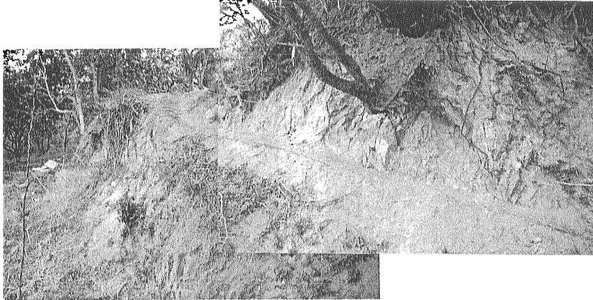
写真37 野島東地震断層に直撃された風化花崗岩の法面。老人憩の家から約120m東方の山道。崩落土砂除去後の法面には、断層破碎を受けた形跡はなく、節理面がそのまま保存されている[服部撮影(1996.1.29)].
