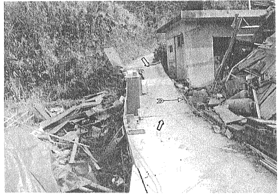
写真46-2 舗田氏邸北側のコンクリート小径二か所のできた開口亀裂(矢印)。先方の開口亀裂は、鉄筋コンクリートブロック製平屋(トイレ・浴室)に面するあたりで反り上がっている。この亀裂の下には、排水溝が埋まっており右の方から左の方の急斜面下の畑に向かって雨水などが流下する。もう一か所の開口亀裂は、コンクリート小径が緩く曲がる所。野島東地震断層は二か所の開口亀裂の中間あたり(矢羽印)を通る[水野清秀氏撮影(1995.1.26)]。
