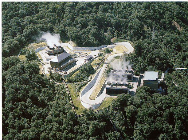
葛根田地熱発電所の全景
