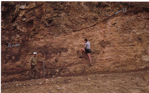
6. D 3 スラストの例 (A-B)。左上の珪化した超苦鉄質岩とチャートが、南側（写真の左）から蛇紋岩化した超苦鉄質岩（人物のあたり）の上に衝上している。
