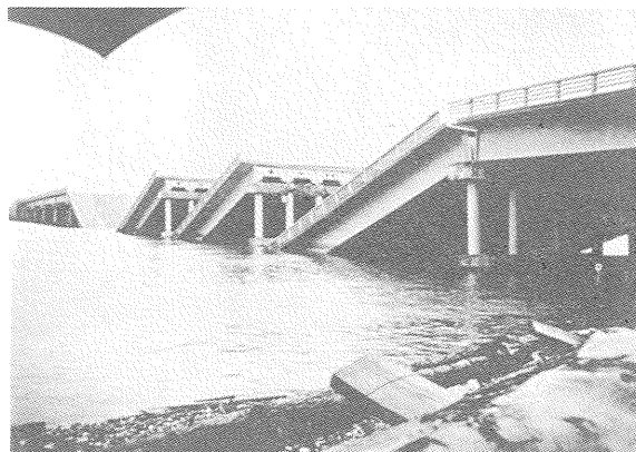
写真2 昭和大橋の被害(文献1)
