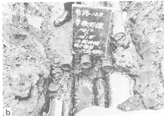
写真1 埋設管の被害例(文献1)
