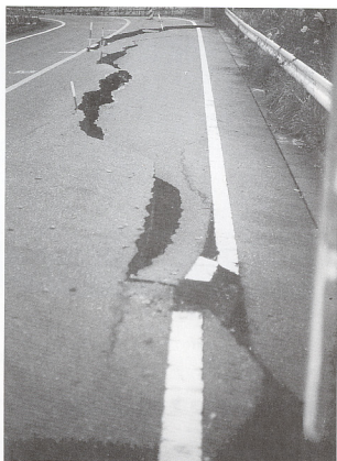
写真9 斜面崩壊によって形成された亀裂・段差（成東町 12月18日撮影）
