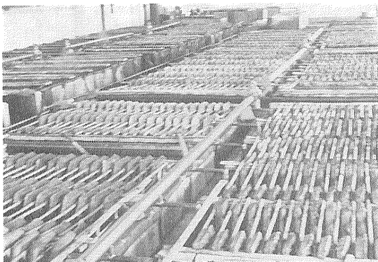
写真3 平北製錬所 電気精錬設備。
