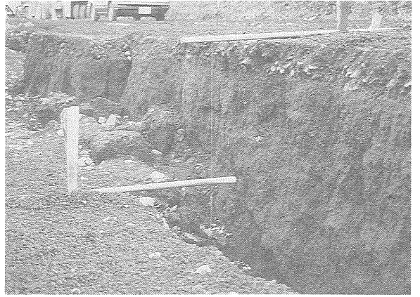
第5図 奥山の一周道路上に形成された断差。(曾屋龍典氏撮影) 落差は70cmに達し 盛り土の崩壊による変位を伴っている。
