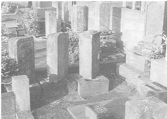
第3図 墓石の回転と転倒(元町墓地) 元町墓地では 多くの墓石が反時計まわりに回転し一部は転倒している。
