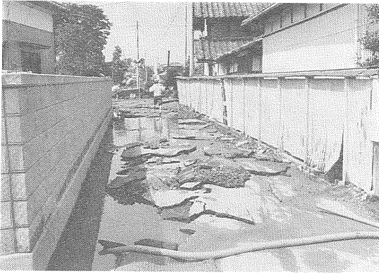
写真-12 水の勢いによってズタズタに割された道路のアスファルト(石下町本豊田にて 1986年8月7日12時半頃 筆者撮影)。下に敷いた砂利との隙間に水が入り アスファルトが浮き上がってしまいました。
