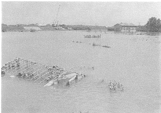
写真-8 石下町本豊田の破堤現場における懸命な復旧工事 (1986年8月7日午前11時30分頃 筆者撮影) 破堤から1日以上経過しても 仮締切工事が完成し ないため 依然として洪水流が流れ込んでいます。
