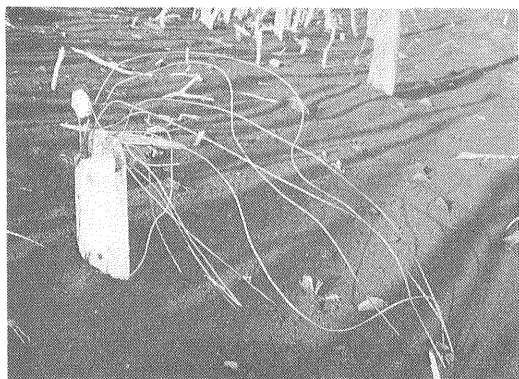
写真7 新霽池からの放出岩塊により破壊され鉄筋がむき出しになった電柱(新霽池新噴火口の東約300m 10月4日午後3時半頃撮影)。
