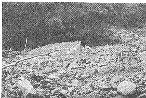
写真4 土石流に伴う堆積物と破壊された砂防堰堤。被災現場から約250m上流
