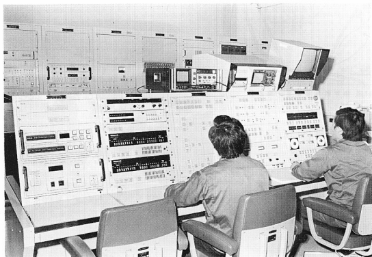
写真3 アンテナ制御卓(追尾装置)
