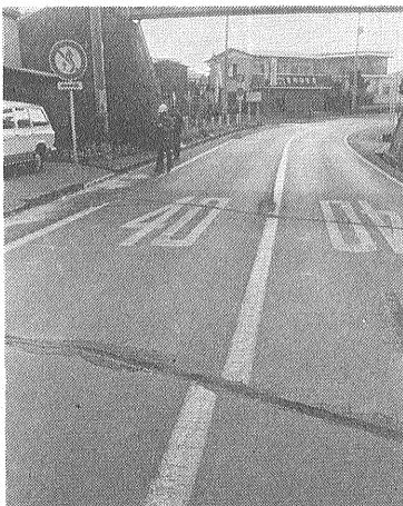
写真3 国道を横切る断層によって道路のセンターラインが右ずれ変位している。このように断層の手前に立って断層の向う側の地面が右手方向にずれる断層を右(横)ずれ断層とよぶ(東伊豆町稲取中学校下国道135号線Loc. 6)。
