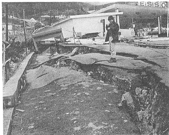
写真2 盛土部分に地割れの生じたガソリンスタンド(東伊豆町黒根 Loc.3).
