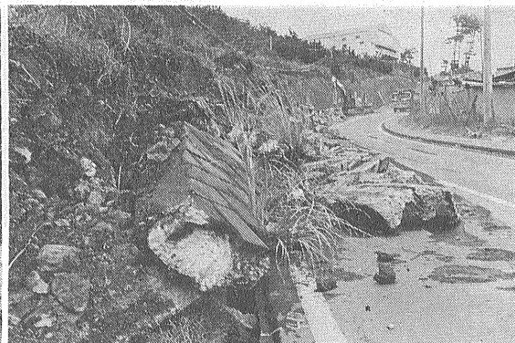
写真30 道路脇の擁壁の崩壊(Loc. 4)。
