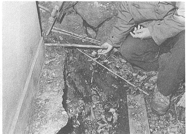
写真8 断層が横切ったため 民家の基礎が浮き上げて口を開いている (Loc. 10)。
