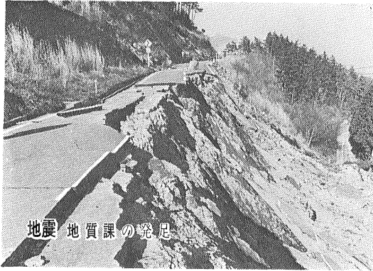
大分県中部地震による道路の被害（五〇・四・三）
