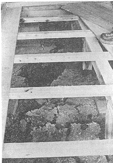
写真⑦ 地震断層の直上に生じた地割れ(渡辺よね子さん宅)たる木と桁の桝が右まわりにひずんだ
