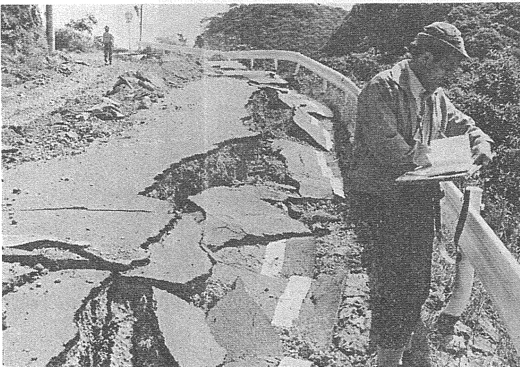
写真30 中木地区北部の県道の被害(石廊崎地震断層の直上部にあたる)
