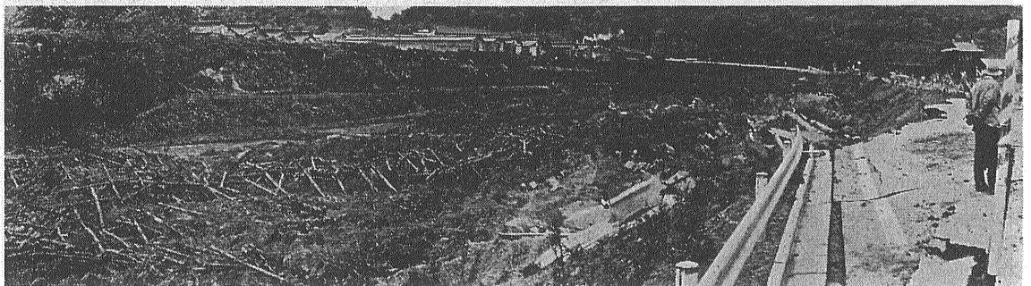
写真10 国道4号線の三戸町上目時地内における損傷状況 段丘のふちから盛土ではり出した部分がかおれている
