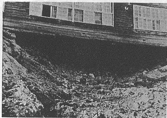
写真17 谷にまたがって建てられた剣吉中学校(第20図参照) 左側が土砂くずれにより4名の犠牲者を出したところ。写真ではよくわからないが 右側背後の山の1部がくずれ 無数の亀裂が残っている。
