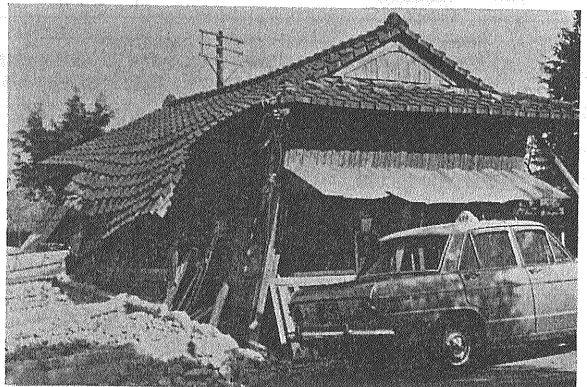
つかい棒でやっと支えられた民家 (京町温泉) 左側の全壊家屋はすでに倒壊されている
