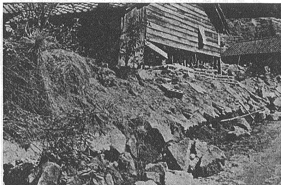
崩壊した石垣とブロック積みの下回り（錦田）
