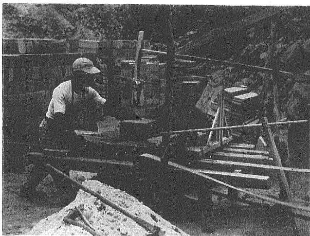
写真6 抗火石の切断加工中 動力はジーゼル発動機 人の後方に積んであるのは規格石 手前は鋸の削屑(新島にて)
