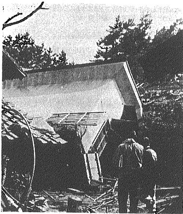
②内野街道越後線寺尾駅の南西方約800m海岸砂丘南縁部 倒壊土蔵 地震とともに砂の地盤が約80cm盛り上がり 波打ちながら傾き沈んだという
