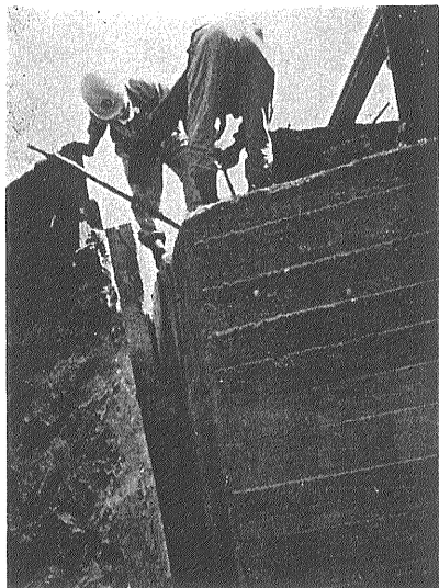
②新潟県岩船郡 山北村勝木付近 羽越線の小鉄橋 の破損
