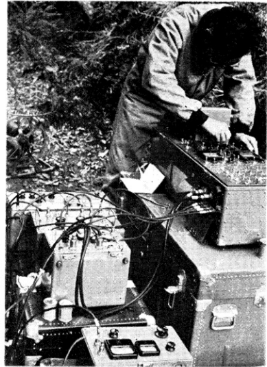
電気検閲の測定器
