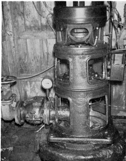
工 場 用 深 井 戸 ボアホールポンプ井
