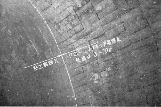
セメント製造用ロータリーキルン焼成帯内側
