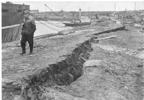
地震による埠頭の被害(釧路市)
