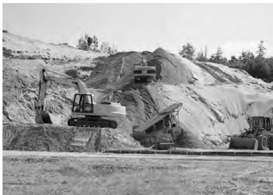
写真21 益田市西側の丘陵地帯では、砂丘砂が建材用に採掘されていました.
