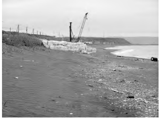
写真33 知来別の海岸。段丘下を走る国道の脇、少しでも浸食されると、早速工事が行われるようだ。
