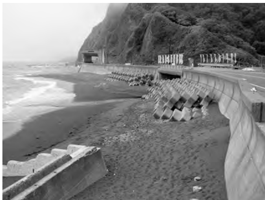
写真36 黄金海岸の浜、えりも町目黒付近。海が荒れると、道路は大波に洗われ、通行止めとなる。
