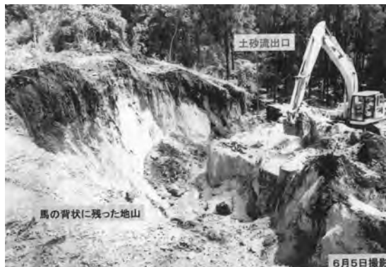
写真2 谷側の陥没地での捜索状況。
