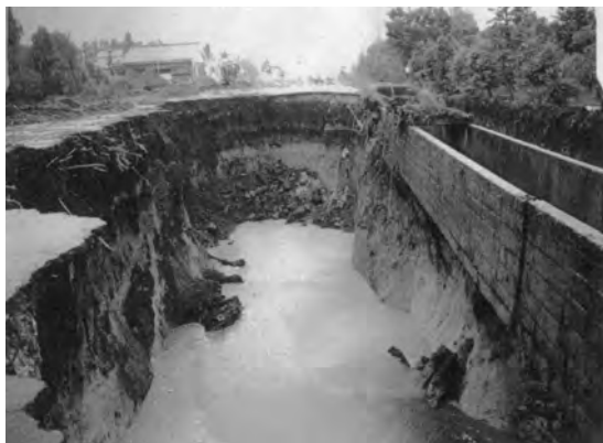
写真1 事故直後の陥没状況 (2000年6月3日)。
