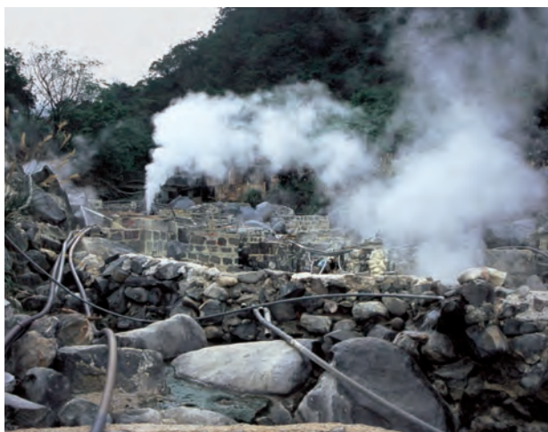
写真16 龍鳳谷の分湯施設。多くのパイプが入り組んでいます。部外者には、どの温泉水がどの施設に供給されているのか全くわかりません。
