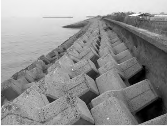
写真11 干拓地の海岸. 高い護岸堤の下にはテトラポッドが並べられている。
