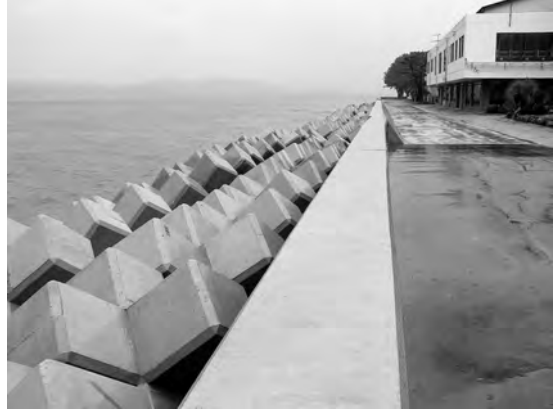
写真26 浸食との戦い。護岸堤の下にテトラポッドがびっしりと並べられている。
