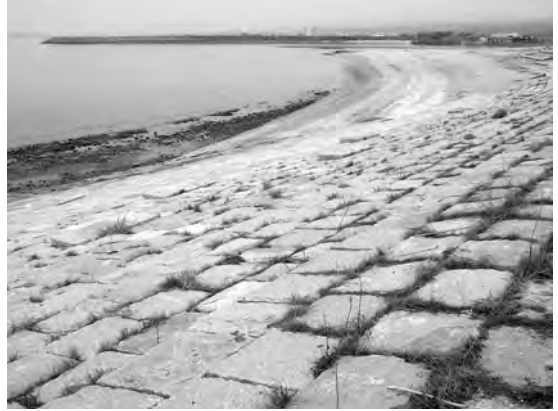
写真7 椎田浜の宮の人工海浜。花崗岩の護岸の向こうに投入された白い砂が見える。
