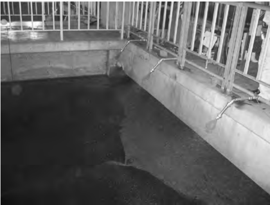
写真5 下水処理用の生物反応槽。
