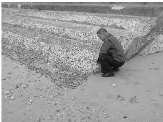
写真23 階段状のコンクリート護岸の浸食。伊勢湾の波も想像以上に荒いようだ。
