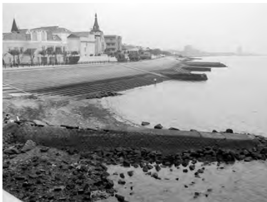
写真2 護岸堤の下、傾斜護岸の下の砂浜はやせ細り、護岸には海苔が繁茂している。
