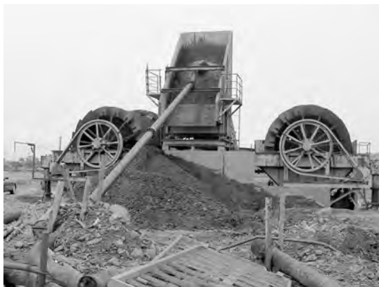
写真18 砂利の選別。吸い上げられた泥水混じりの砂利は、木片などが除かれ、篩い分けられる。
