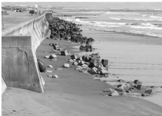
写真2 砂の失われた海岸。護岸の下のテトラポッドが並び、申し訳程度の砂浜が残る。
