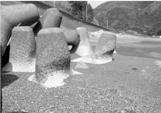
写真6 中土佐・小矢井賀浜。防波堤の下のテトラポッドが浸食されている。
