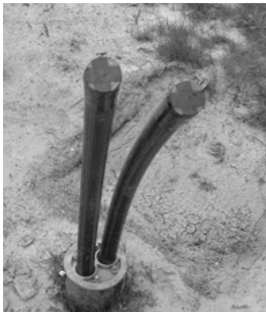
写真2 ルンド大学で埋設されたU字管。 これを地上のシステムに繋げる。
